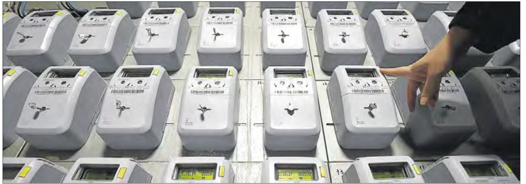
► Contadores eléctricos en una finca de viviendas de Barcelona.
