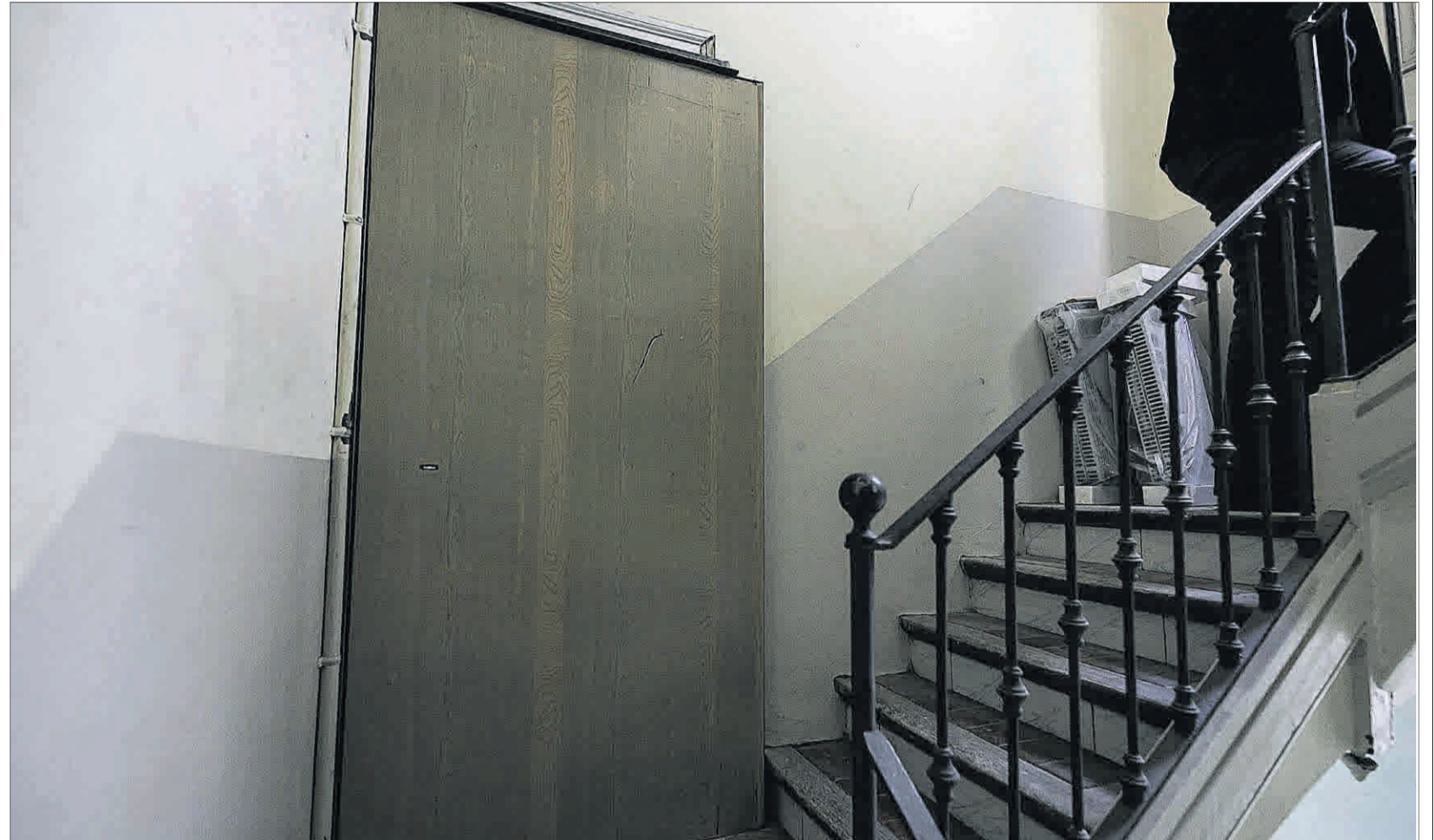
►► Deshabitado ►Piso de un banco con una puerta antiocupas, en la calle del Hospital, en el Raval de Barcelona.
