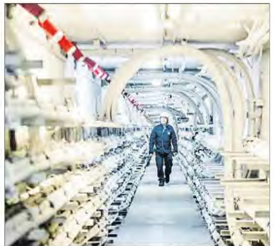
Un operario revisa el buen funcionamiento de la subestación de Mata
