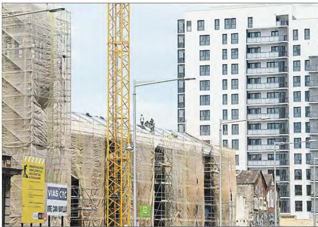
En construcción. Una de las promociones de obra nueva que se están construyendo en la zona de Can Batlló
