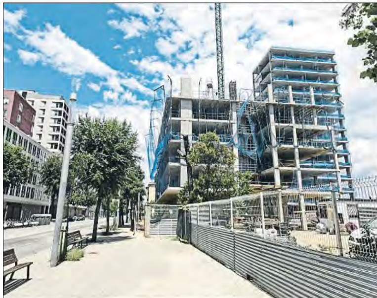
Terrenos de los antiguos cuarteles de Sant Andreu donde se construye vivienda libre y protegida
